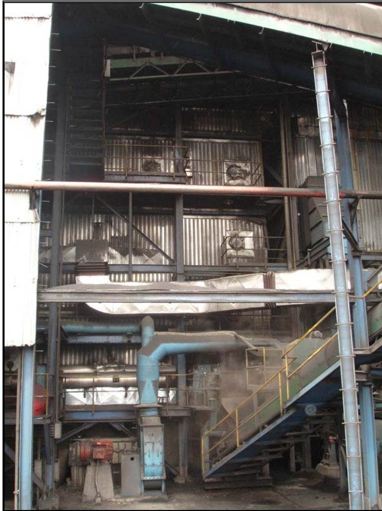
Figura 8. Ventilador tiro forzado VTF. Aire de combustión caldera 5.
