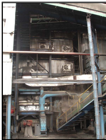
Figura 3. Ventilador tiro forzado VTF. Aire de combustión caldera 5.
