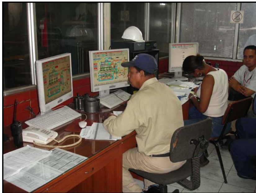
Fig. 10. Panel de control. Cuarto control calderas
