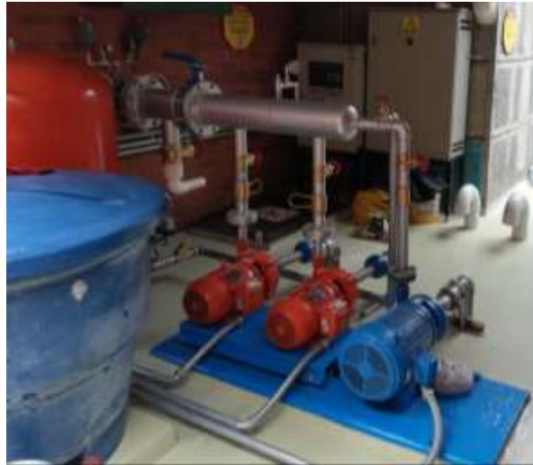
Sistema de bombeo de la PTAP de la UAO
